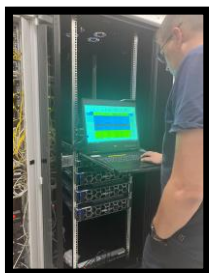
Dépannage dans le local technique
