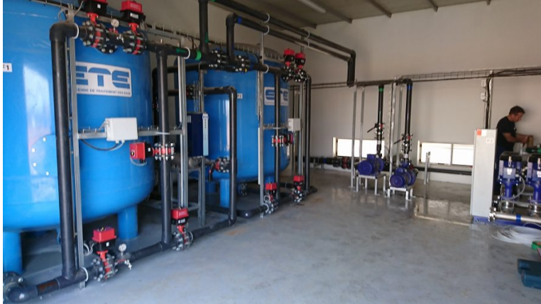
47 Local ETE à Fazenda Filomena en Angola, avec des cuves de 20 000L
