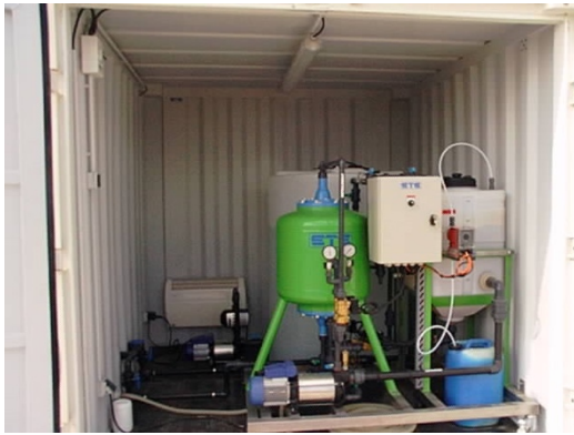
12 Skid de filtration
