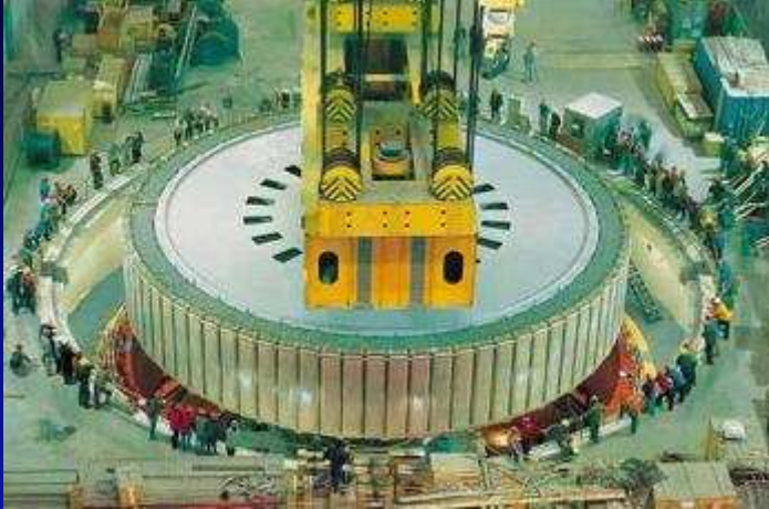
Turbine de l'une des 26 centrales hydroélectriques
